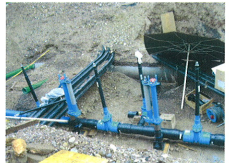
Verteilung in der Baumannstraße Strecken-/ Hausanschlussschieber
