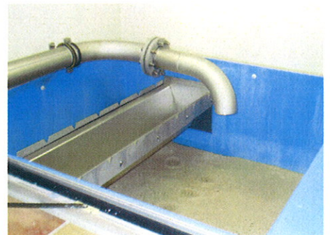
Filter im Behälter Schönenbach
