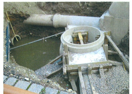
Kanal „Schacht in der Baumannstraße“
