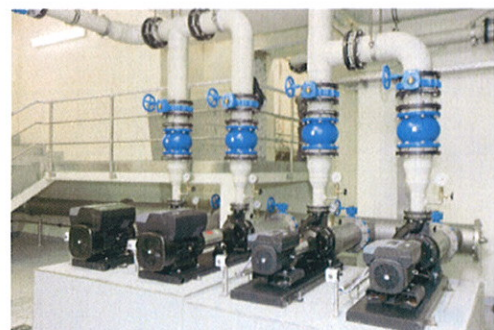
Pumpen für Rückspülung
