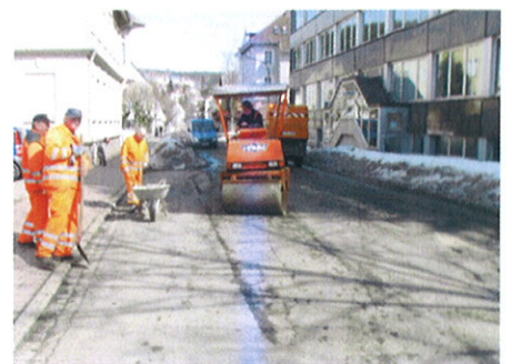
Flickzug Straßenschäden in der Baumannstraße
