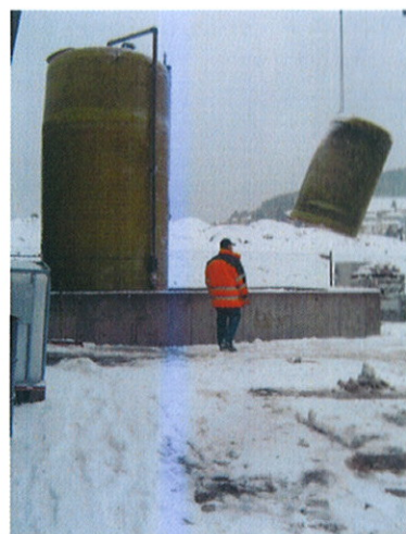
Flüssigsalzbehälter bei der Kläranlage
